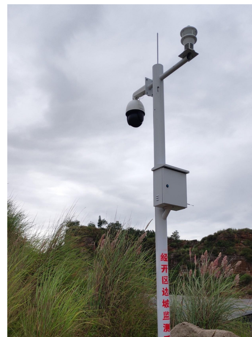
一体化雨量监测站
